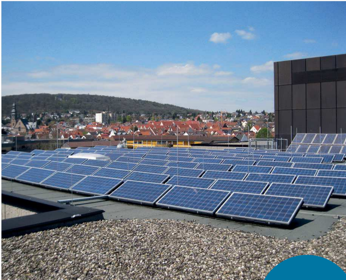
Photovoltaik-Strom vor Ort nutzen
