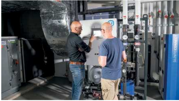
Durch die zwei Wärmetauscher im Keller des Gebäudes ...
